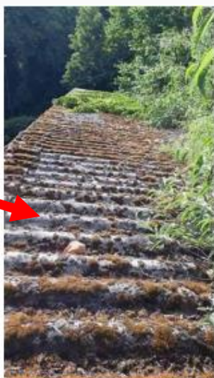
Matériaux : ZPSO-013 Prélèvement : P013 Description : Plaques en fibres-ciment Localisation : Chenil - Toiture Résultat : Présence d'amiante Quantité : 250 m2
