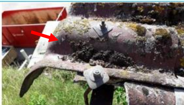
Matériaux : ZPSO-014 Prélèvement : P014 Description : Rive de façade Localisation : Chenil - Toiture Résultat : Présence d'amiante Quantité : 40 ml
